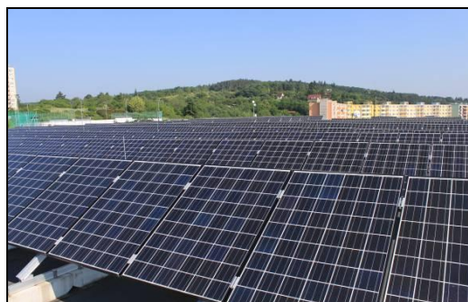
Obr. 60 Plocha solárních panelů na střeše základní školy Foto: V. Doskočilová
