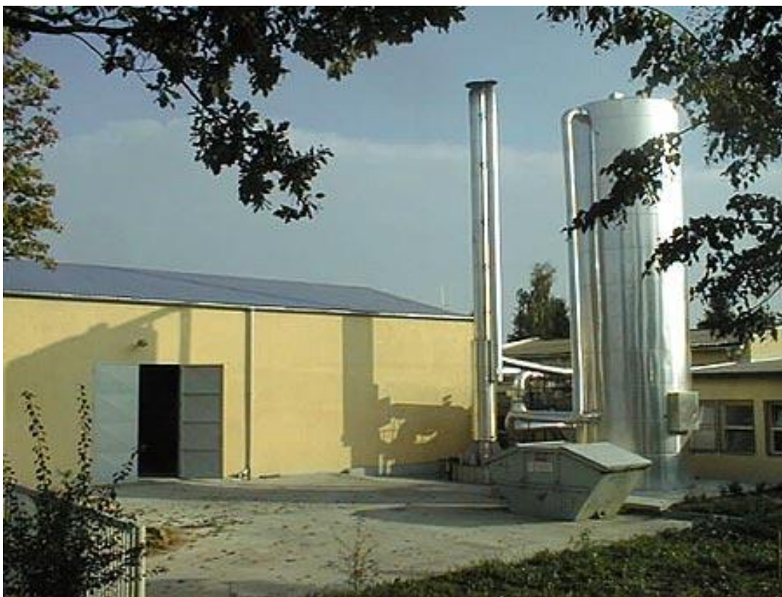
Obr. 13 Zařízení na spalování biomasy ve Velkém Karlově. Zdroj: Atlas zařízení, využívajících obnovitelné zdroje energie. Sdružení Calla, přístupné z http://calla.ecn.cz/atlas/detail.php?id=1347&kat=3&img_id=2159 , staženo 14.12.2013.
